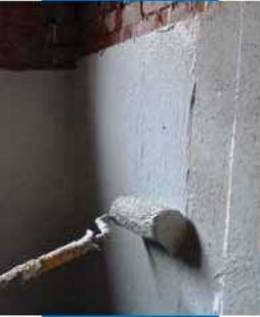
Mapelast ic foundation užtepimas voleliu ant pagrindo, išlyginto naudojant Planitop HDM Maxi
